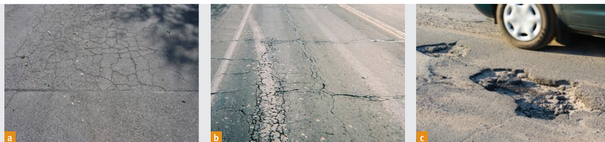
Estructuras de pavimento inadecuadas: a) agrietado tipo piel de cocodrilo; b) agrietado en bloque; y c) fragmentación a causa de humedad excesiva dentro de la estructura.
